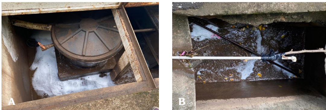
Figura 7 – Caixa SAO subdimensionada, extravasando (7A e 7B). Fotos: Bárbara Dornela.
