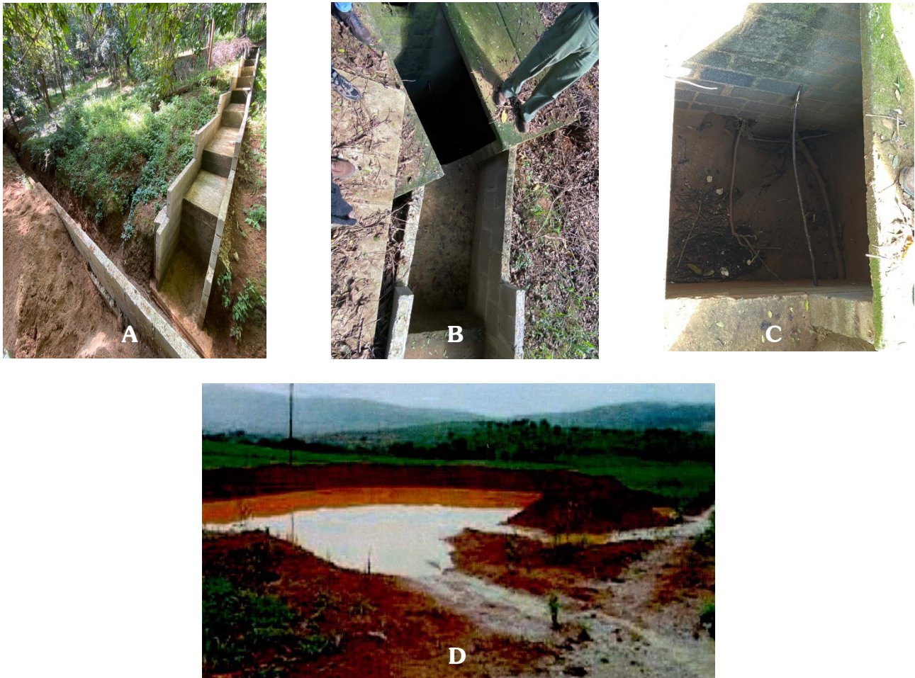
Figura 4 – Escada dissipadora de energia (4A); Caminho percorrido pela água (4B); Caixa de sedimentação (4C); e Caixa de Sedimentação efetiva (4D). Fotos: Bárbara Dornela. Fonte: Relatório de cumprimento de condicionantes de um dos empreendimentos visitados.
